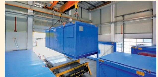
E-Haus Produktion E-house production
